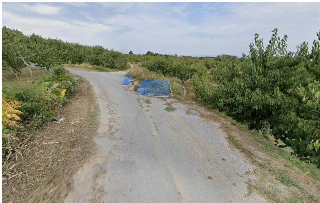
ΦΩΤ. 7 (ΚΑΡΥΔΙΑ / ΑΠΟΚΑΤΑΣΤΑΣΗ ΤΕΧΝΙΚΟΥ - ΟΔΟΣΤΡΩΣΙΑΣ – ΑΣΦΑΛΤΟΤΑΠΗΤΑ)
